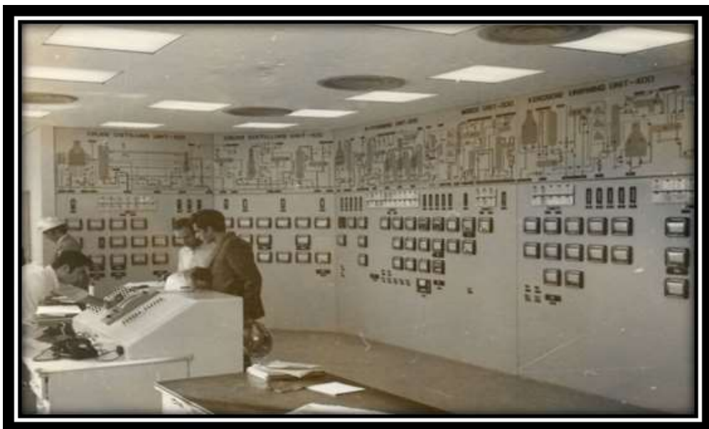
تصویر ۹: یکی از ایستگاه‌های نیمه‌اتوماتیک برق پالایشگاه نفت کرمانشاه
